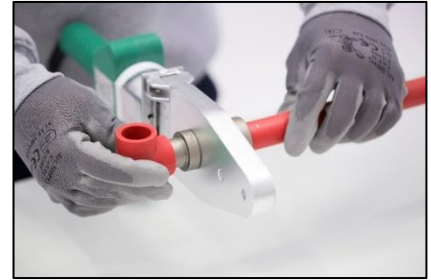
Figura 3. Aplicación de calor al tubo y al accesorio mediante las matrices correspondientes.
